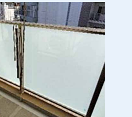
転落防止のための 手すり
